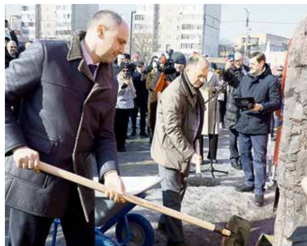
▲ Под вспышки фотокамер Денис Паслер и Денис Сафин уложили первую порцию бетона на месте, где вырастут два многоквартирных дома
