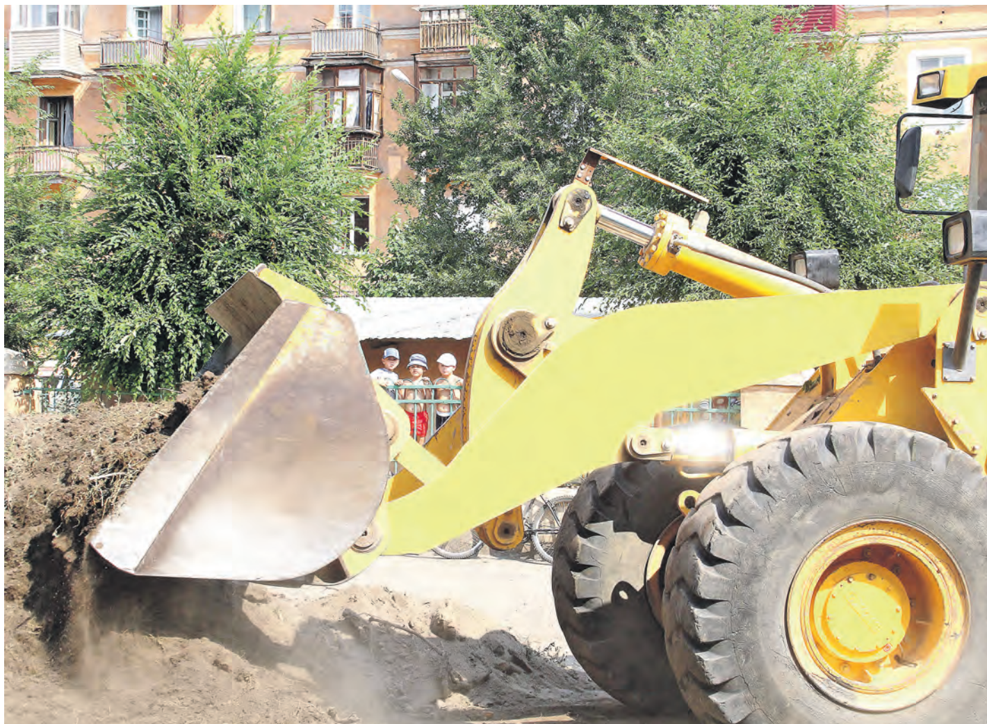
Воспитанники расположенного во дворе детского сада с интересом наблюдают за работой тяжелой техники
