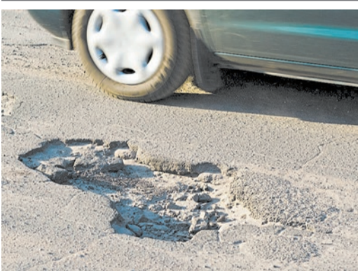
Выявлено более 160 нарушений по ремонту дорог
