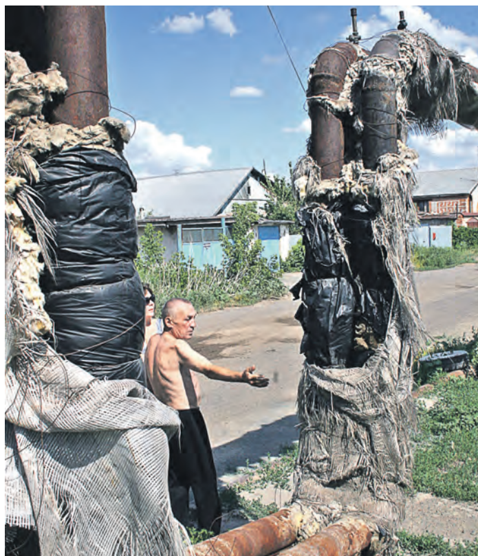
Оголенные трубы центрального отопления в городе пока не редкость, каковы при этом теплопотери, остается только догадываться
