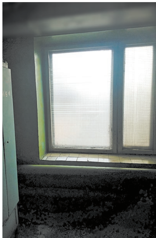
Запись о разбитом стекле в душевой четвертого этажа КХП появилась в журнале 7 февраля, а уже в понедельник 8 февраля неисправность была устранена
