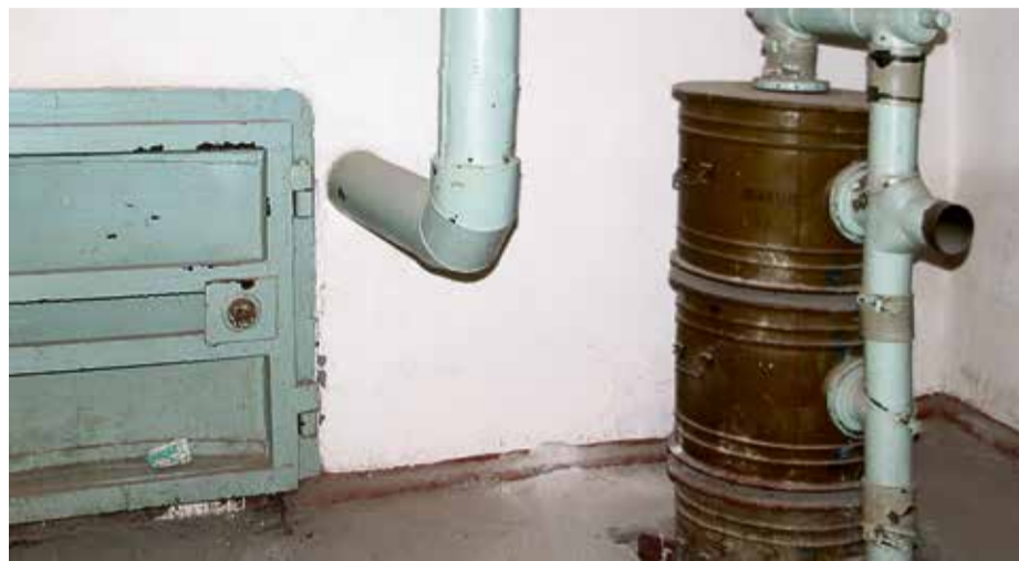
◀ Слева — запасной выход из убежища, справа — установка для очистки воздуха
