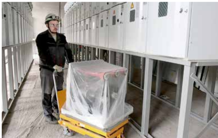
▲ Новым котлам — новейшее электрооборудование
