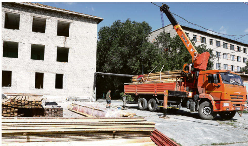
▲ До начала осенней непогоды строители возведут над зданием новую крышу, чтобы дождь не мешал отделочным работам внутри помещения
