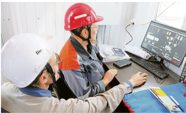
▲ Оператор производства с монитора компьютера будет в реальном времени контролировать все параметры процесса приготовления бетона
