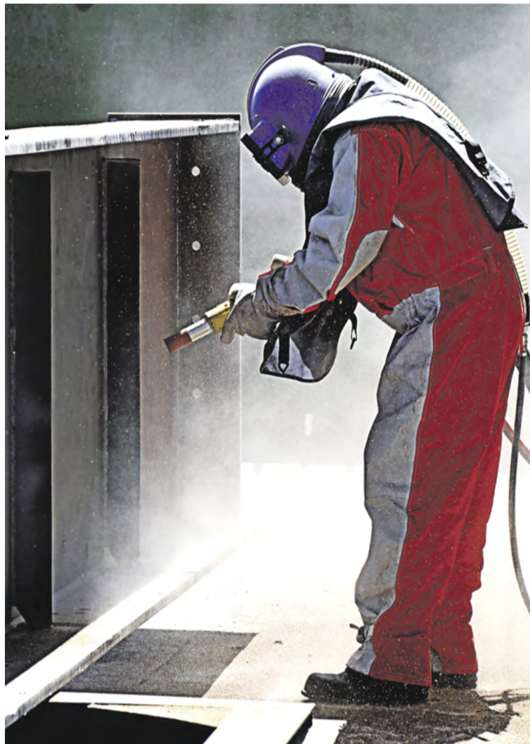
▲ Одежда специалиста по абразивной обработке напоминает костюм водолаза: в шлем, который препятствует попаданию пыли в лёгкие, подает воздух
