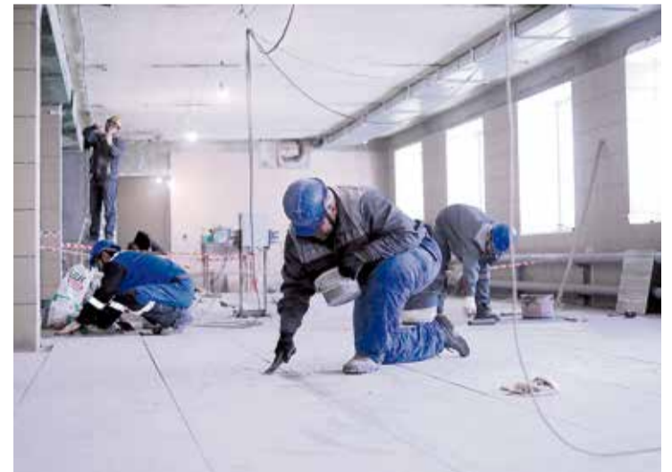
▲ Грамотно спланированные ремонтные работы позволяют строителям работать на разных уровнях: пока одни заканчивают отделку полов, другие заняты прокладкой электропроводки
