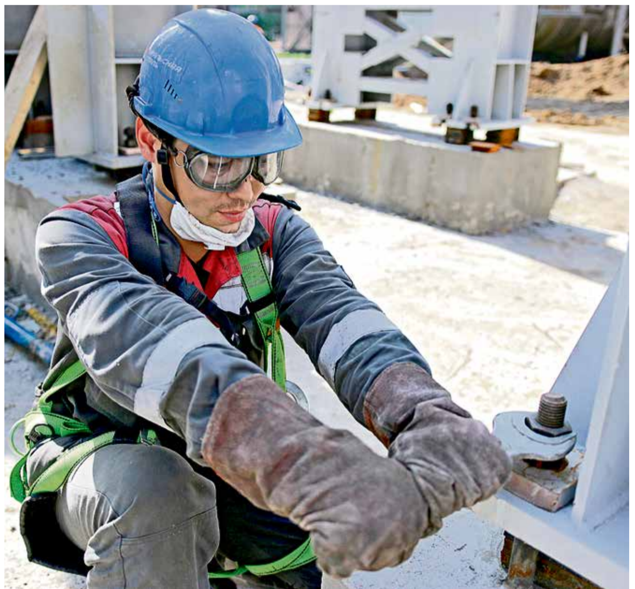
▲ Монтажник Дмитрий Петухов — один из тех, кто трудится на возведении воздуходелительной установки в кислородно-компрессорном цехе
