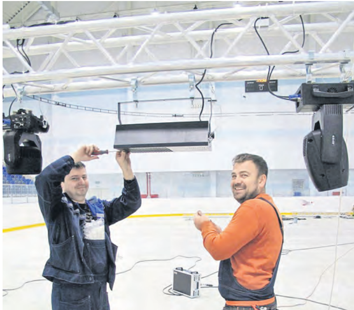
Монтажникам компании «АВЛ» Евгению Клянишину и Владимиру Родину не привыкать к работе на спортивных объектах
