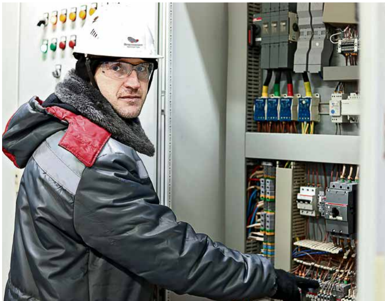
▲ Электрик ККЦ Евгений Алюкин — опытный рационализатор. Редко какой капремонт цеха обходится без новаций Алюкина. Евгений разрабатывает не только индивидуальные проекты — он всегда рад действовать в команде
